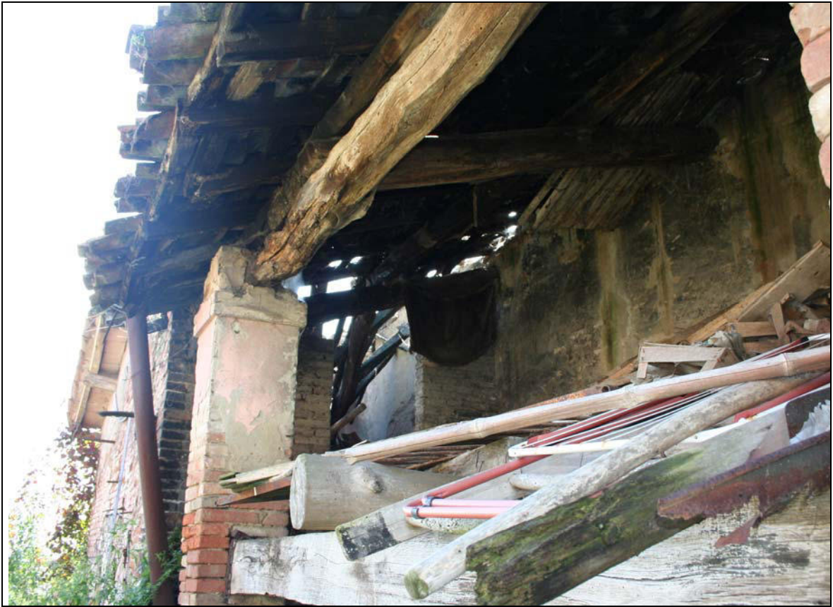
Foto n.6 particolare crollo copertura
