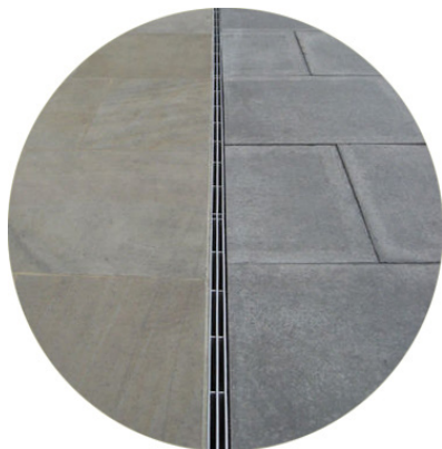
Caditoia lineare di deflusso acque
